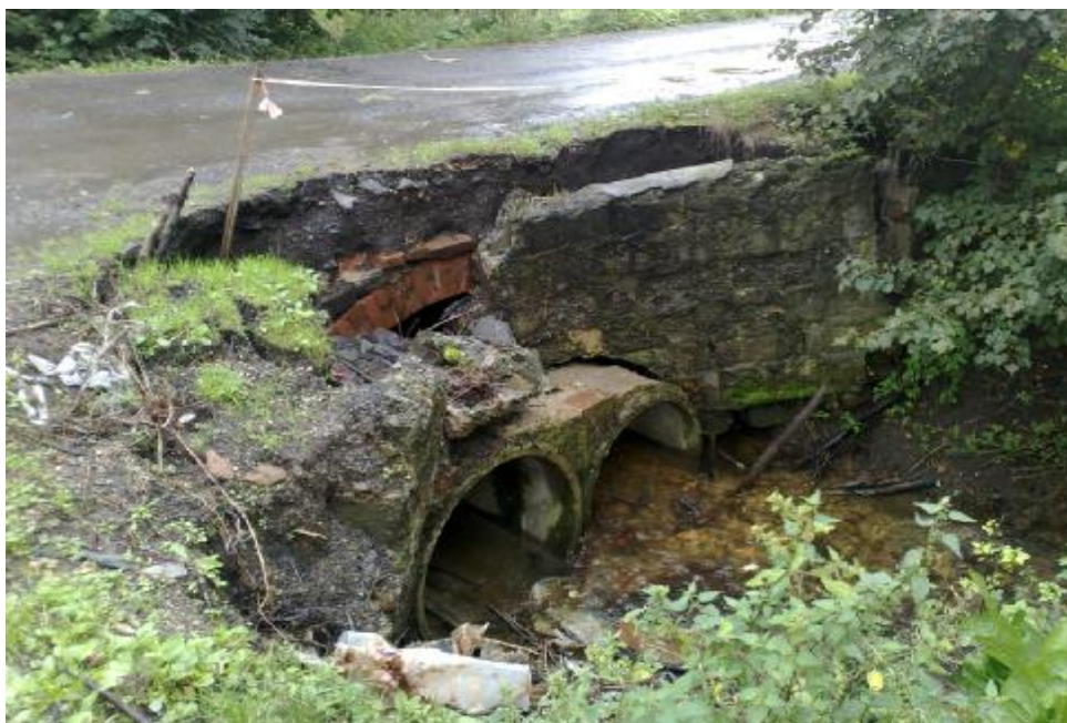
Fot. nr 1. Zniszczony przepust nad rowem melioracyjnym w miejscowości Grabiszycie g. Leśna
