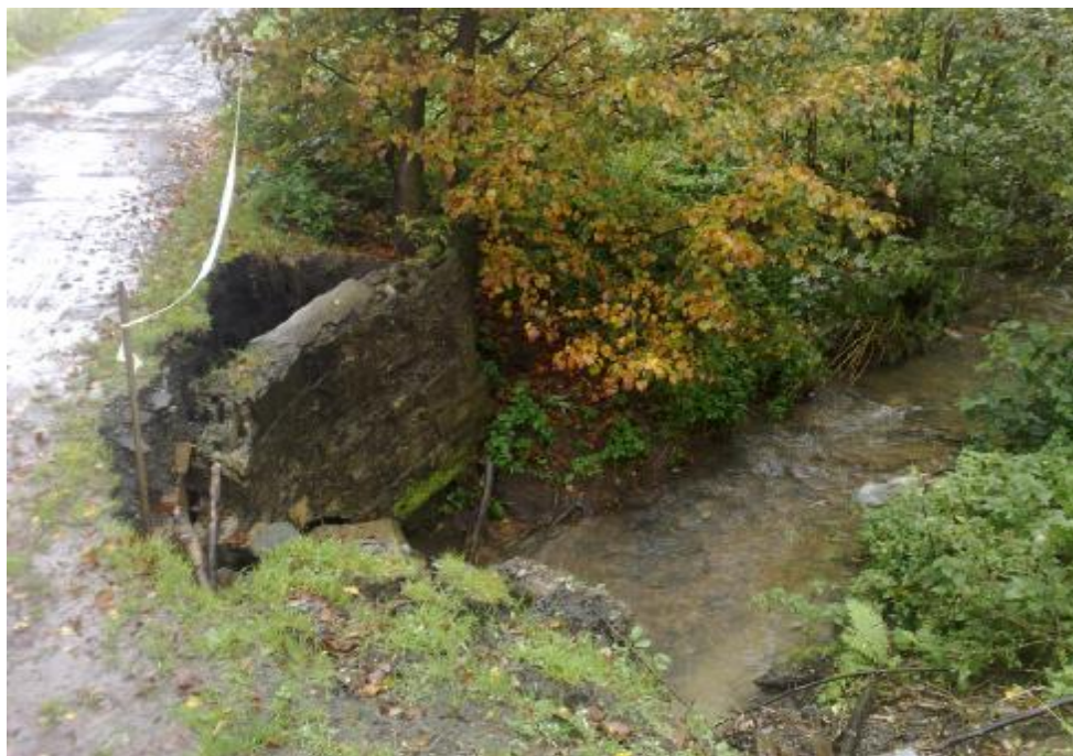
fot. nr 2. Widok zniszczonego przepustu.
