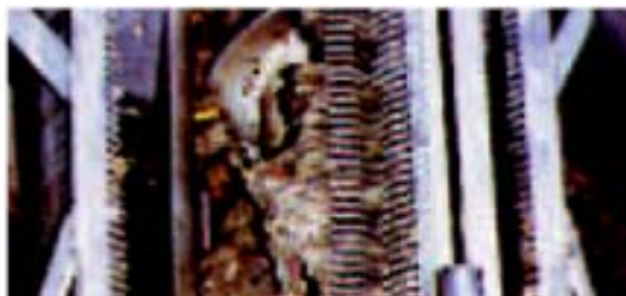
Materiał powierzchniowy i zawieszony jest zatrzymywany na koszu kraty. Zgrzebla automatycznie przeczesują kosz usuwając zanieczyszczenia.
