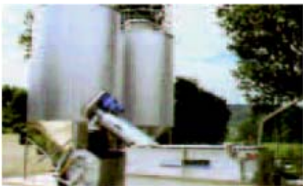
Zbiorniki retencyjne, zapewniające równomierne podawanie osadów na oczyszczalnię ścieków
